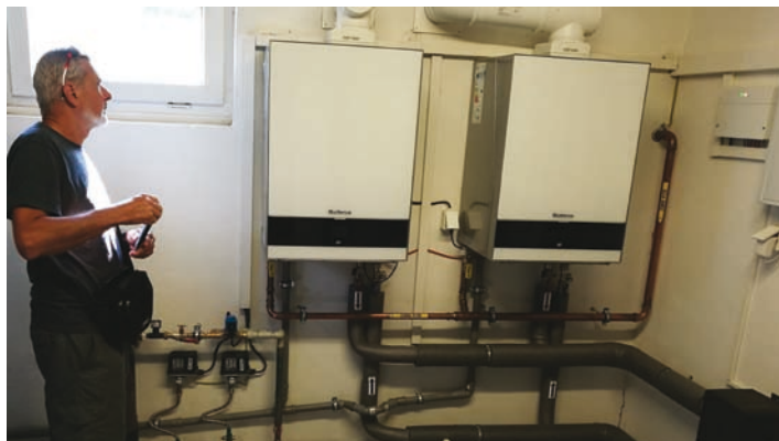
SBD Energy: Bezpečnost kotlen je u nás na prvním místě!
