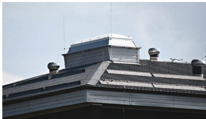
Detail požární klapky.
