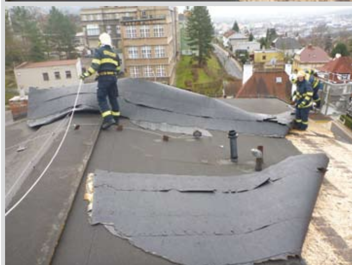
Škodní událost: Větrm poškozená střecha na objektu Stoliční 1206/5
