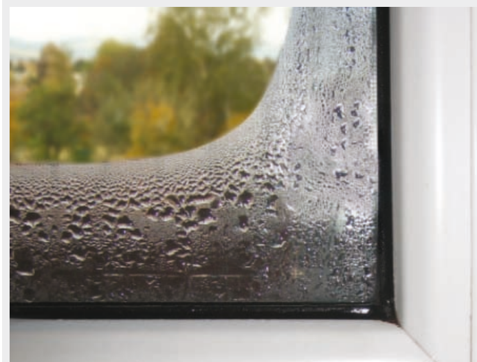
Obrazky, které bohužel zná mnoho uživatelů bytů – orosená okna, vlhko, plíseň... foto: Termocon s.r.o.
