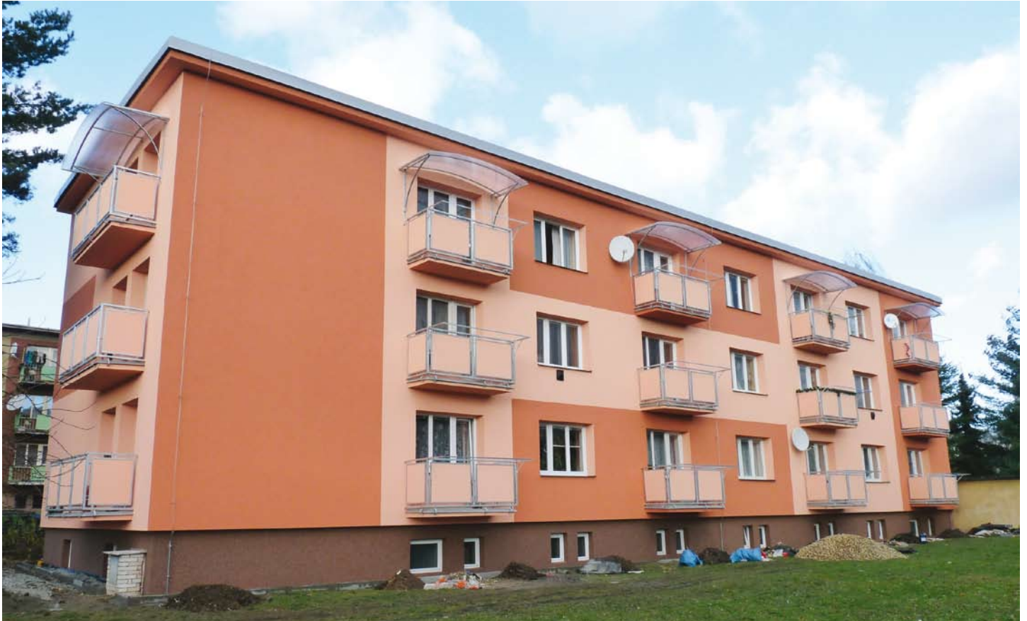
Zateplením objektu nejenže výrazně ušetříte na nákladech, ale uděláte službu i zdraví všech bydlících. Na snímku objekt SVJ v Krásnostudenecké ulici, kde je předsedou pan Evžen Fryblík
