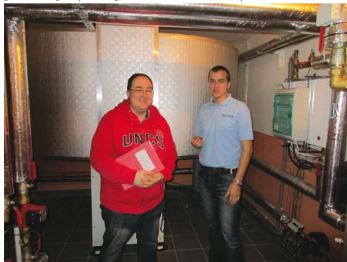
Fotografie z kolaudace nového tepelného čerpadla v roce 2015. Ing. Konopásek je na snímku vlevo, vpravo je Ing. Zbyněk Dvořák, zástupce fy ACOND, a.s.
