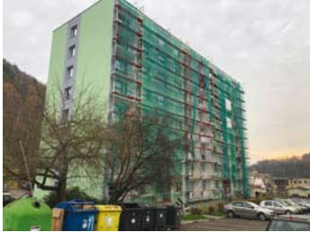
Bytový dům Rudolfova 247, 248, Děčín IX během nedávné rekonstrukce. Vpravo pohled na hotové dílo.
